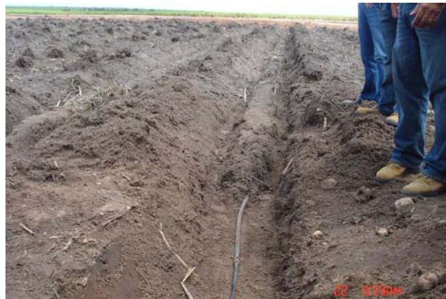
Fotografía 12. Detalle de la tubería de goteo enterrada en Ingenio Coruripe.
