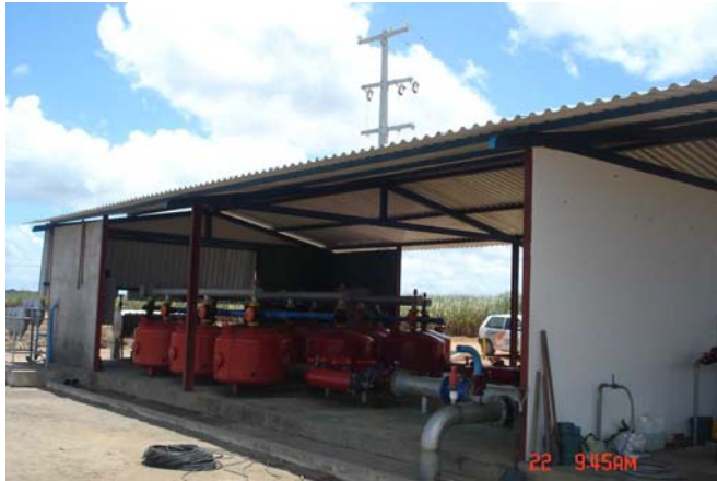
Fotografía 10. Estación de bombeo y filtrado
