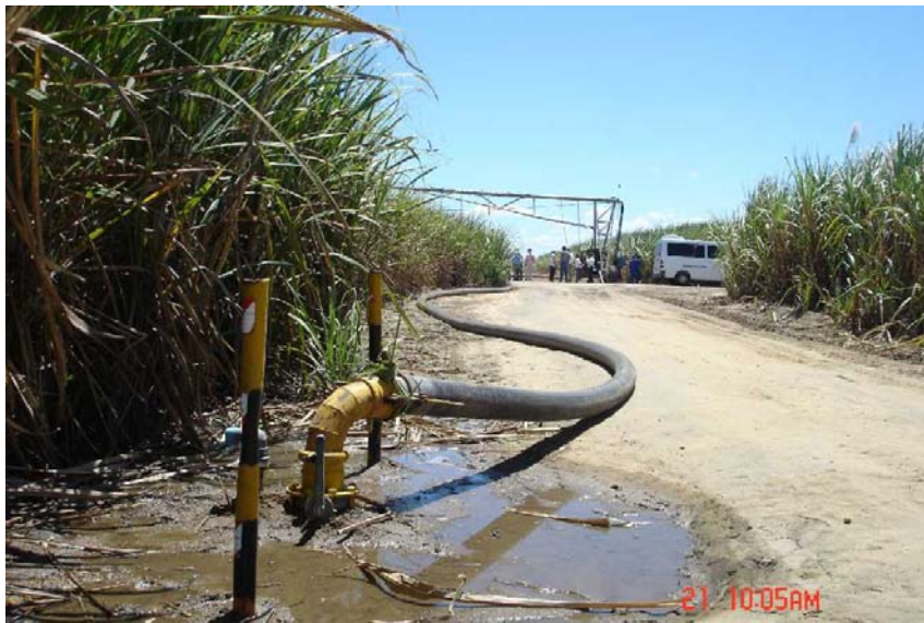
Fotografía 1. Punto de alimentación de un sistema de riego lineal en Ingenio Caete. Manguera conectada a hidrante sobre la tubería enterrada.
